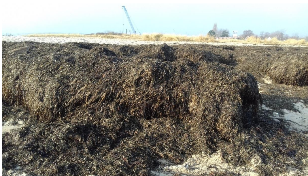
Abb. 4 Treibsel als Schutz für Abbruchkanten, der Treibselanwurf ist höher als die Abbruchkante (Foto: Kai Ahrendt)
